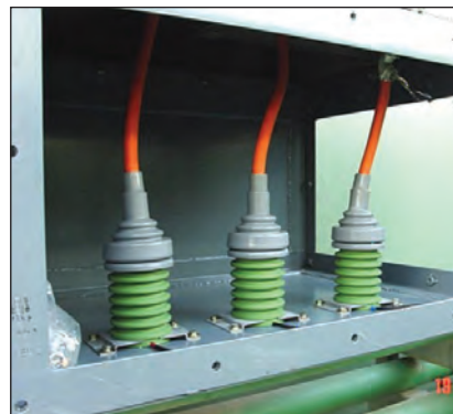
Acopladores Capacitivos Instalados
