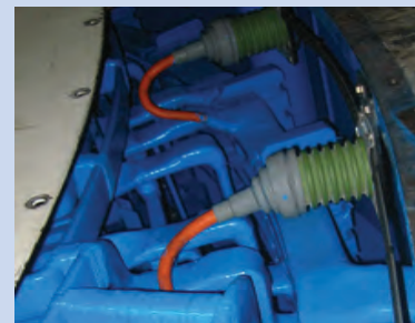
Acopladores Iris Power PDA instalados em um hidro-gerador
