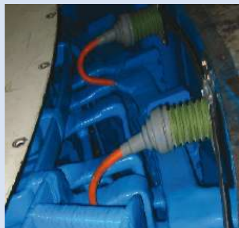
Acopladores Iris Power PDA instalados dentro de un hidrogenerador
